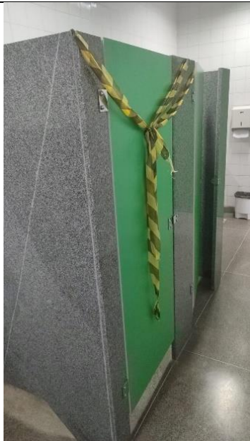
Necessidade de reparos hidráulicos em cabines Sanitárias do Bloco E
