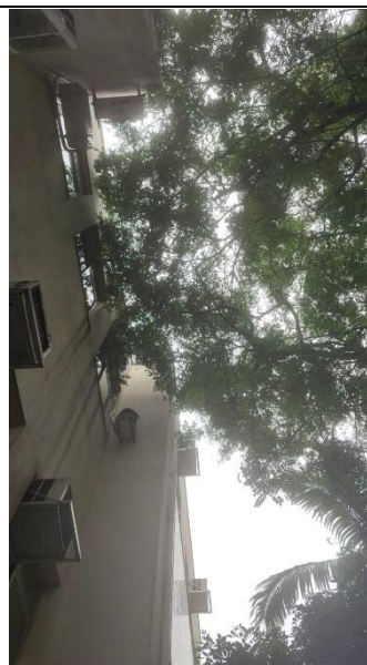
Risco de quebras de vidros de janelas do terceiro andar da fachada frontal do Bloco A por falta de poda
