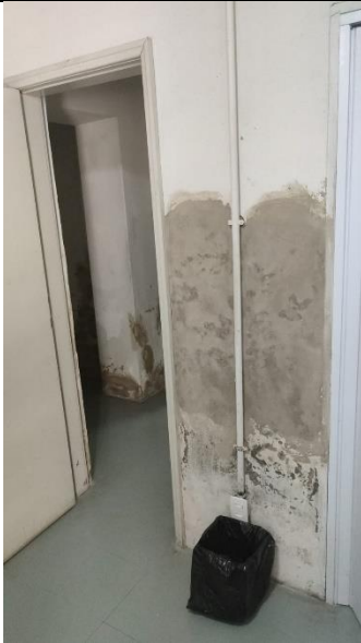
Necessidade de complementação de reparos de paredes com pintura no DST
