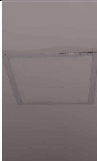
Vazamento no hall de elevadores no 7º andar do Bloco E
