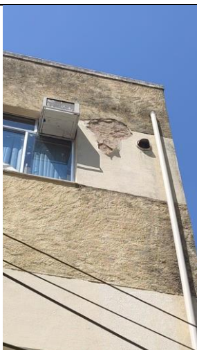
Fachada Lateral do bloco E com deslocamento no Bloco A
