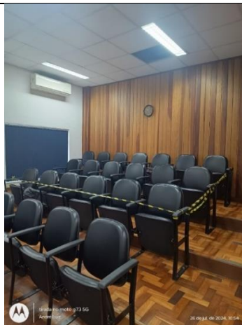
Bloco A – Parte do Auditório interditada devido a infiltração no teto – Reparos em andamento
