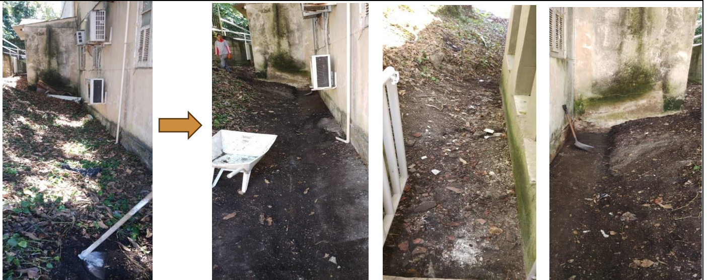
Bloco A – Serviço da SOMA: capina e retirada de terra sobre a calçada. Não resolveu o problema da Infiltração
