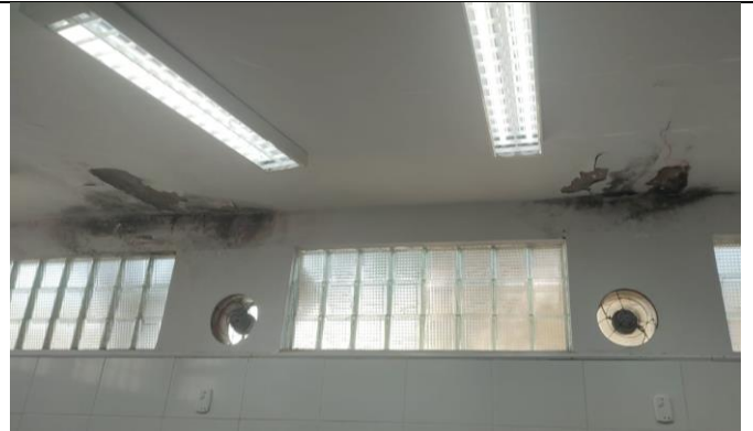
Necessidade de reparo no teto da área de Anatomia Veterinária no Bloco D
