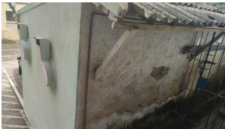
Serviço incompleto da pintura do Biotério de Ratos do Bloco A
