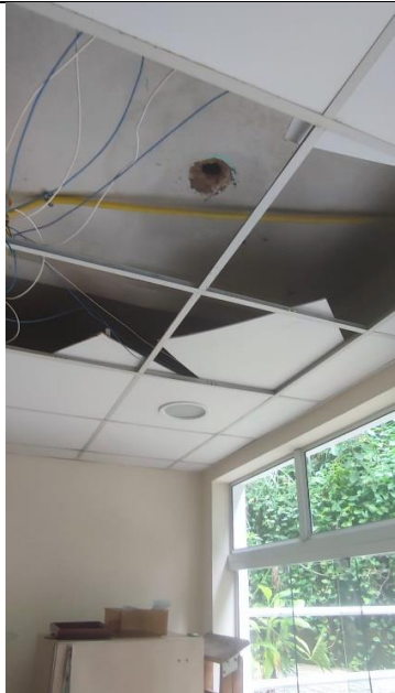
Vazamento na laje da área de coffee break do Bloco A.
