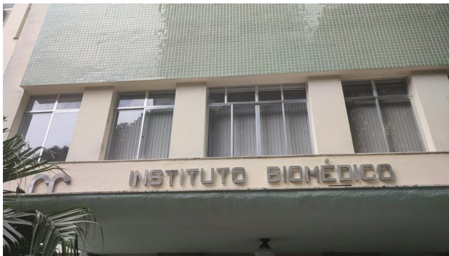
Pintura da fachada Frontal do Bloco A Material do CMB e mão de obra da SOMA
