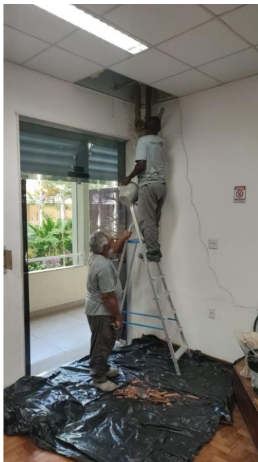
Sanada infiltração da coluna do Auditório do Bloco A
