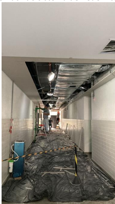
Em continuidade a substituição do forro em gesso dos tetos dos corredores do Bloco E.
