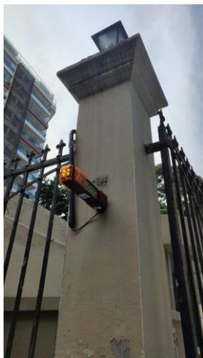
Instalação de sinaleira na saída do Estacionamento do Bloco A – SOMA
