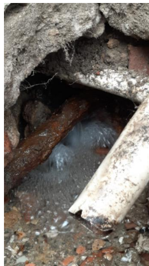
Descoberto e Sanado Vazamento sob o estacionamento do Bloco A que vinha causando grande desperdício de água. SOMA
