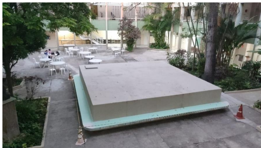
Impermeabilização do assento lateral da cisterna do Pátio Central do Bloco A
