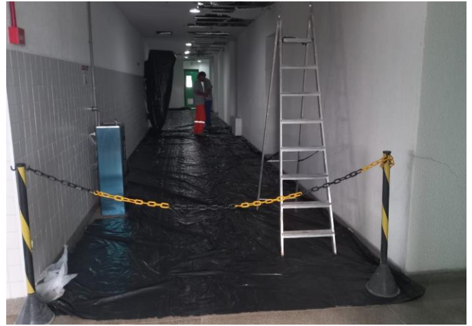
Iniciada a troca do forro do teto dos corredores do Bloco E SOMA
