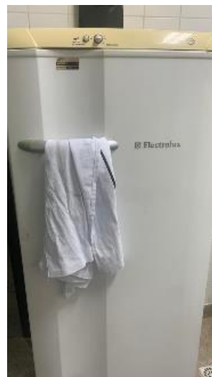
Conserto das geladeiras da copa da copa do 2º andar, sala 311 e 517 – SPECTRU
