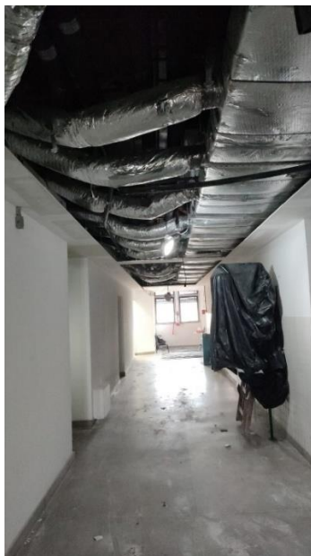
Em continuidade a substituição do forro em gesso dos tetos dos corredores do Bloco E.
