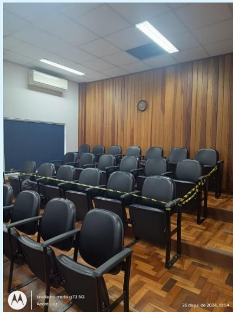
Bloco A – Parte do Auditório interditada devido a infiltração no teto – Reparos em andamento
