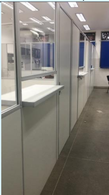
Instalação de Divisória na sala 11 – Bloco E – Secretaria da Pos-grad. em Ciências Biomédicas – Verba da Pós.
