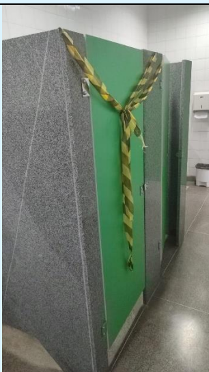
Necessidade de reparos hidráulicos em cabines Sanitárias do Bloco E
