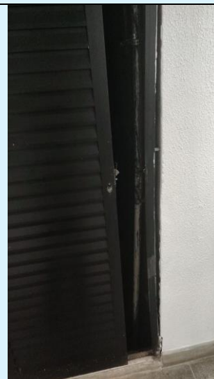
Necessidade de recuperação da porta do shaft do segundo andar do Bloco E que foi danificada
