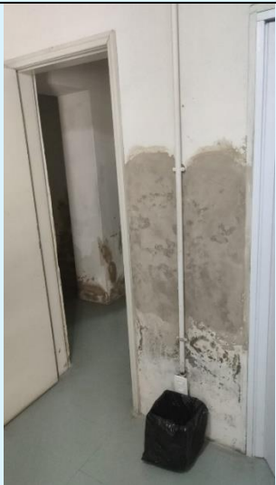
Necessidade de complementação de reparos de paredes com pintura no DST
