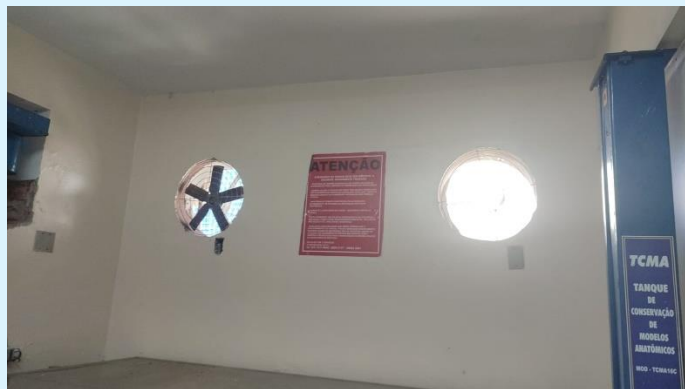
Necessidade de Restauração de exaustores defeituosos ou Substituição
