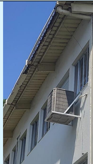
Necessidade de Substituição de calhas do Bloco C
