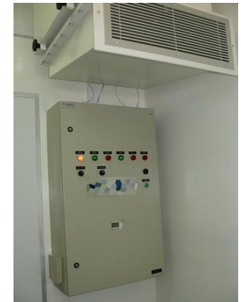
Sistema de pressurização de ambiente
