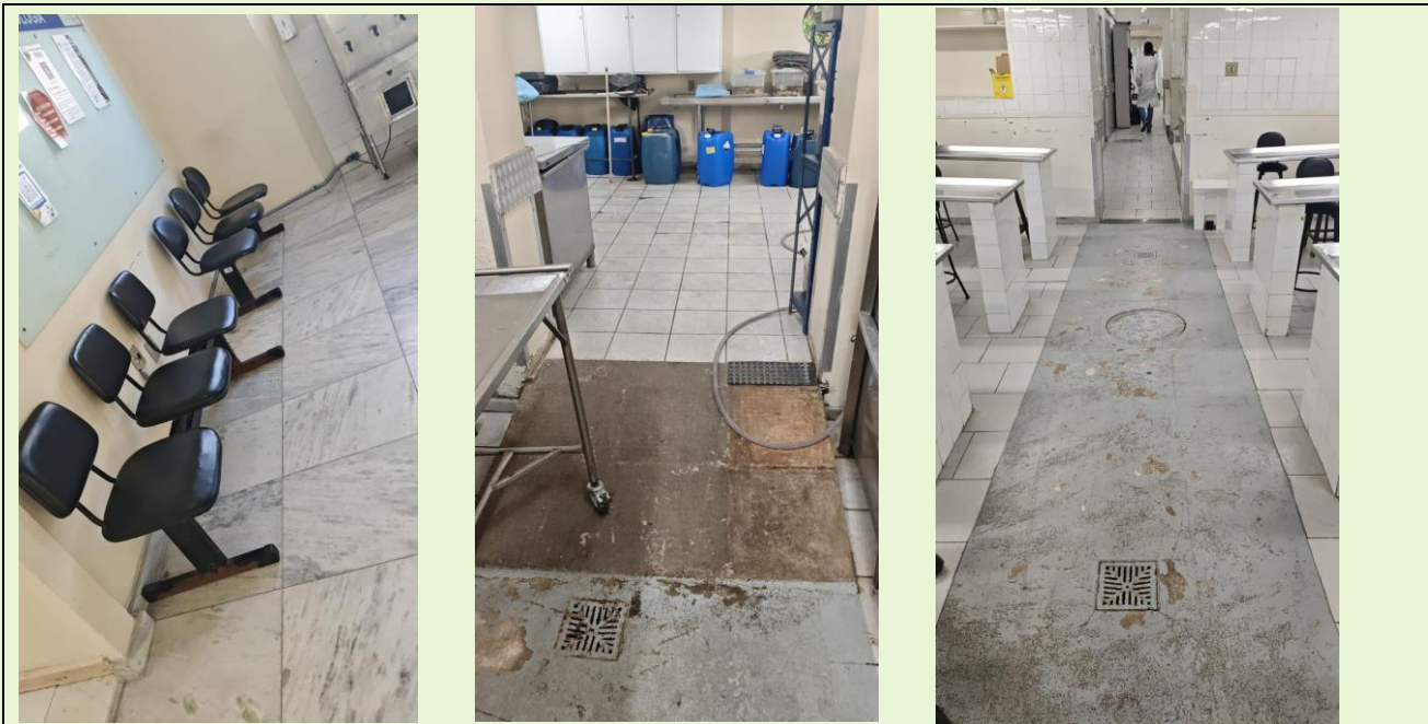
SEM AVANÇO..... Necessidade de pintura das bases das longarinas do Hall do Anatômico e Piso dos Laboratórios de ensino do Subsolo – Bloco D
