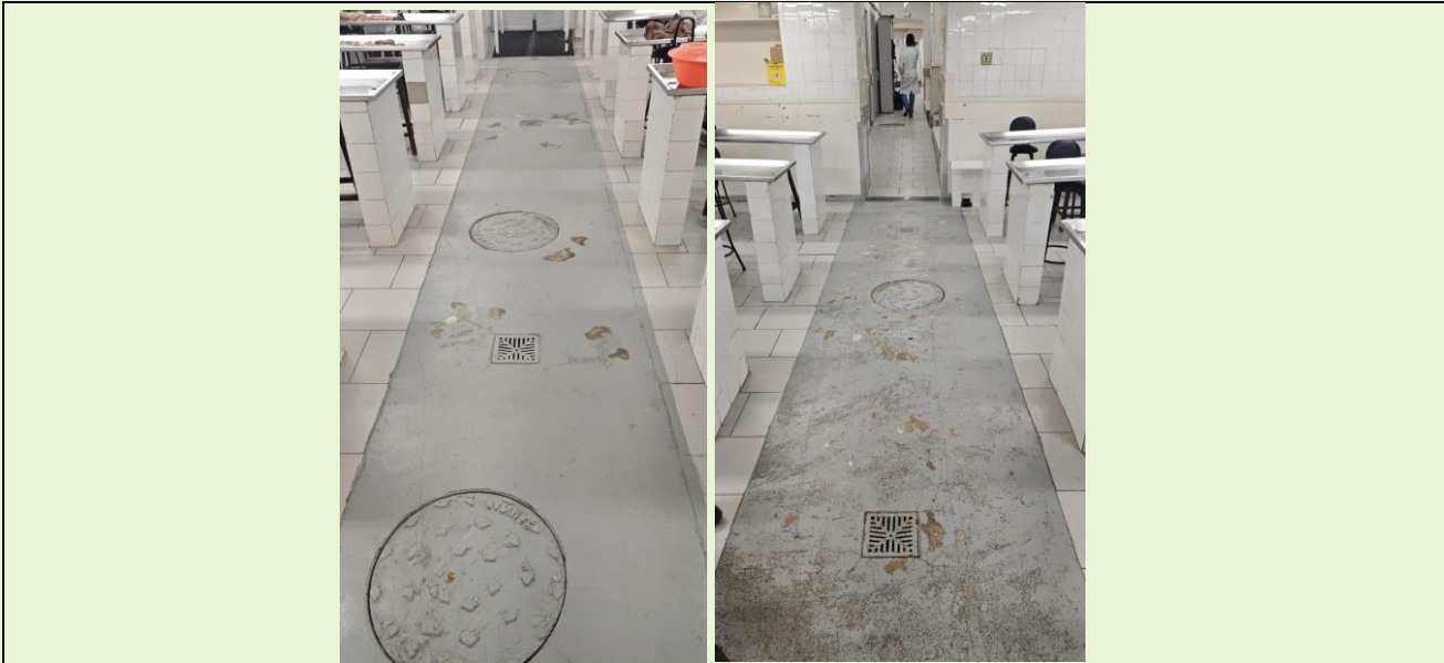
BLOCO D - Necessidade de pintura no piso dos laboratórios de Ensino do Bloco D – Anatômico
