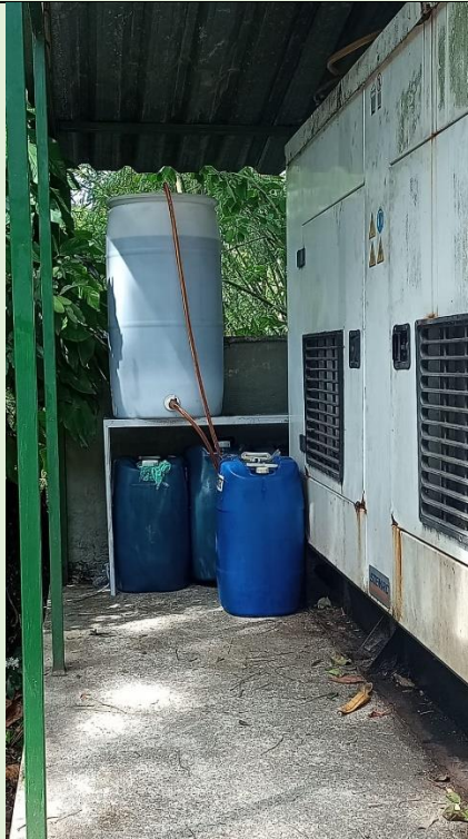
Ocorrências devido a temporal de quinta =-feira – 05/10/2023 – instalação de novo reservatório de combustível no gerador – maior autonomia
